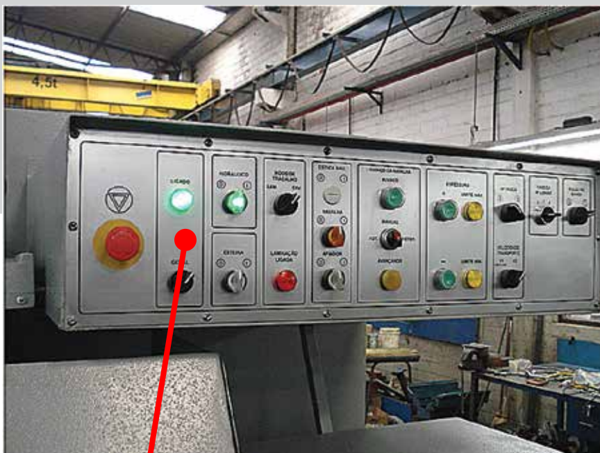
Circuito de comando operando em extra baixa tensão
