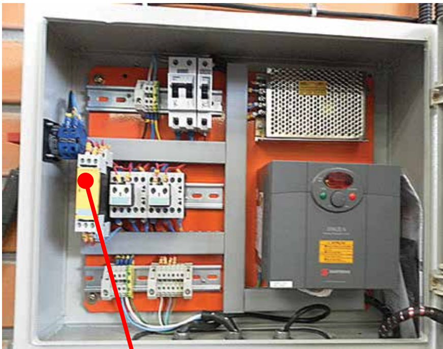
Relé de emergência de monitoramento do cabo de emergência
