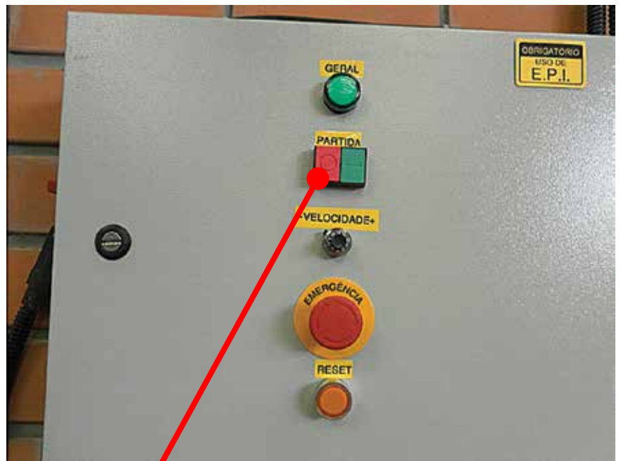
Circuito de comando que opera em extrabaixa tensão
