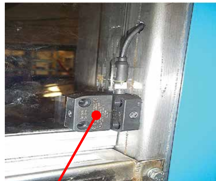
Sensores magnéticos das proteções móveis, que, quando acionados, interrompem o movimento das pistolas e da esteira
