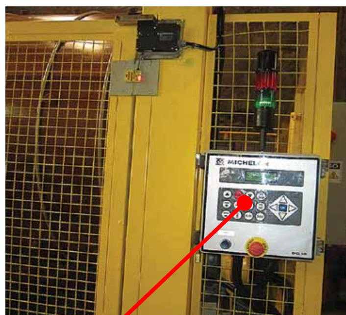
Circuito de comando que opera em extrabaixa tensão
