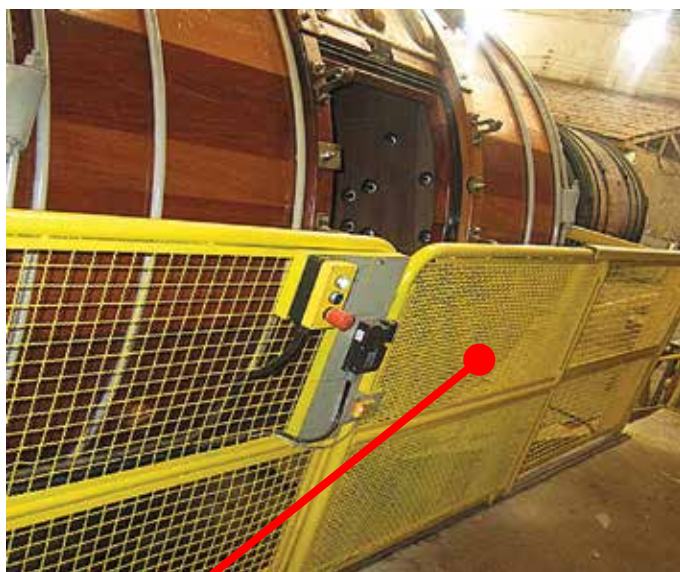
Proteção móvel intertravada com bloqueio, monitorada por interface de segurança na área de abastecimento, observadas as distâncias determinadas no quadro II do Anexo I da NR-12
