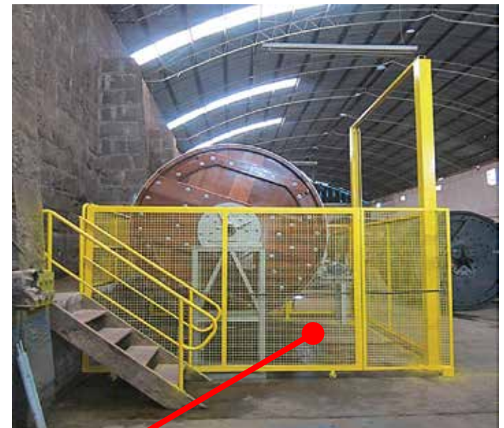
Proteção fixa nas laterais da máquina
