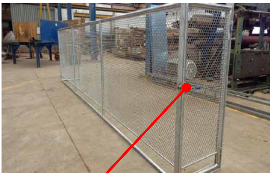
Proteção fixa (na parte posterior) com porta intertravada. Quando a porta é aberta, desliga a bomba, abre a máquina, desliga o movimento do cilindro de navalhas, fecha a proteção articulada e desliga o afiador
