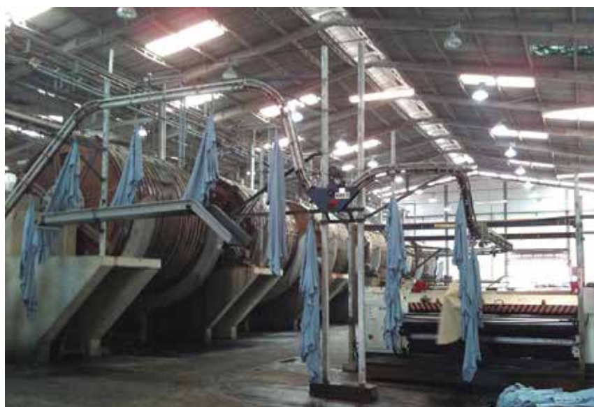
Vista geral do equipamento
