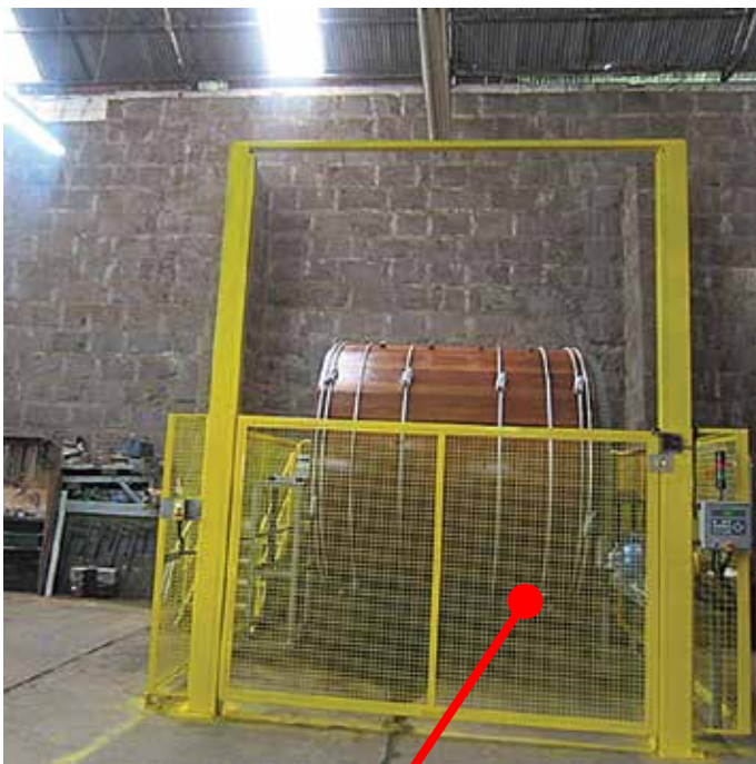
Proteção móvel intertravada com bloqueio, monitorada por interface de segurança na área de descarregamento
