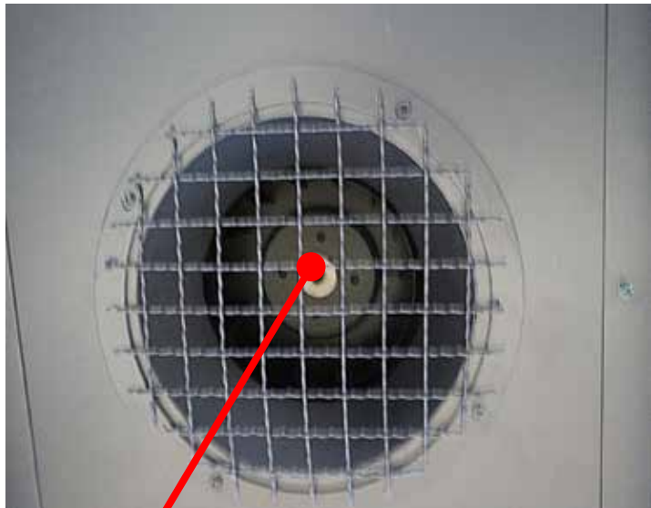
Proteção fixa dos ventiladores
