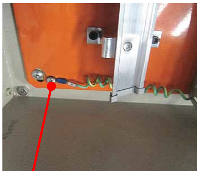
Aterramento da carcaça
